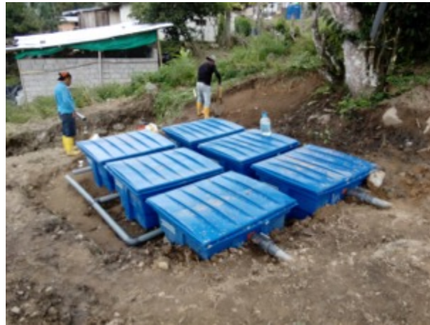
Le vasche di trattamento
