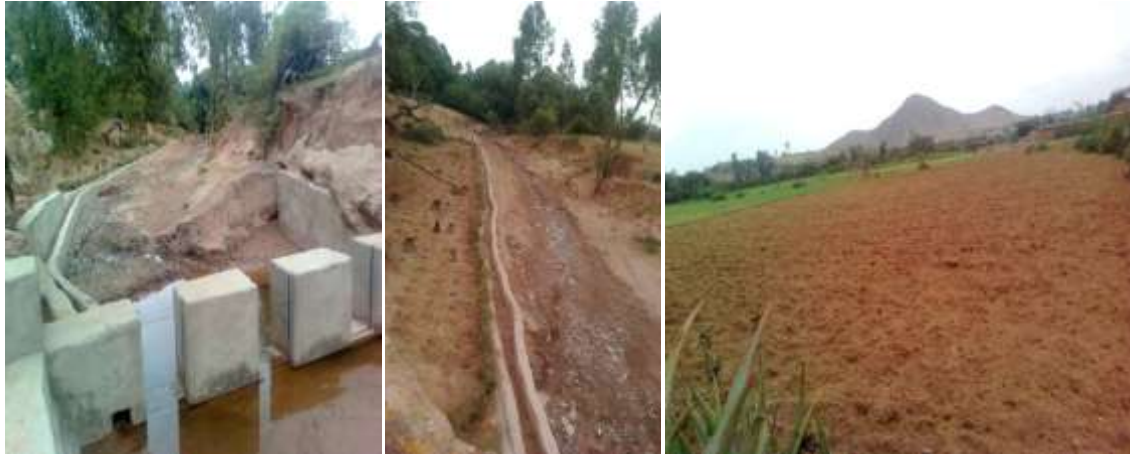
Flussverbauung in einer Schlucht von Ruba mit verlängertem Kanal und dem zu bewässernden Land (Foto: ADCS)
