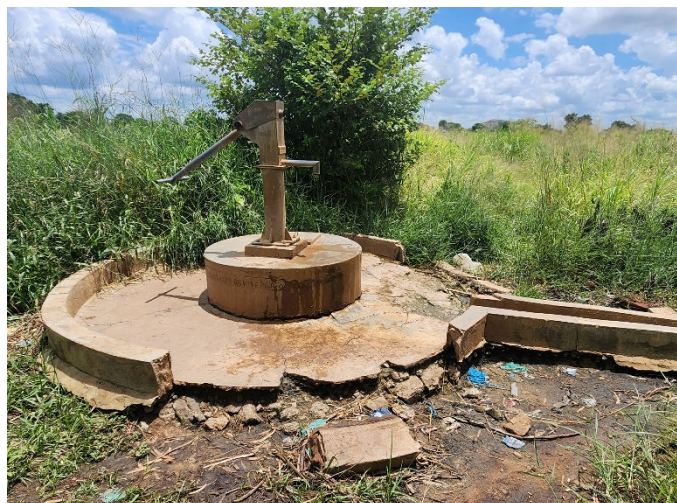
Il ciclone Chido ha colpito duramente l'area d'intervento, danneggiando molte infrastrutture idriche e igieniche. Il progetto, dopo aver valutato tutti i danni, nel 2025 farà in modo di ripristinare gli impianti più necessari e urgenti Foto: Helvetas /
